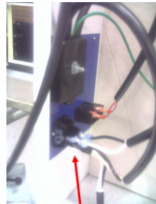
Interrupor principal vista trasera
