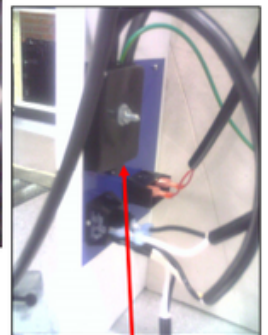
Cable de distribución de voltaje y contacto de sistema de refrigeración (vista trasera)
