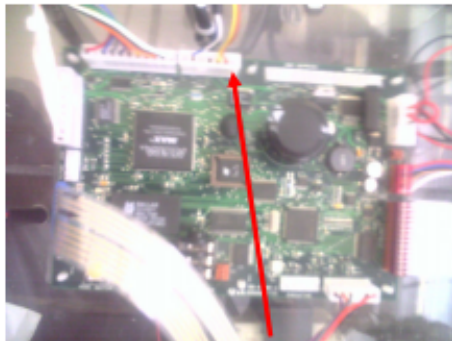
Cables café y amarillo de relay de refrigeración.
