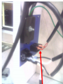
Portafusible por la parte trasera
